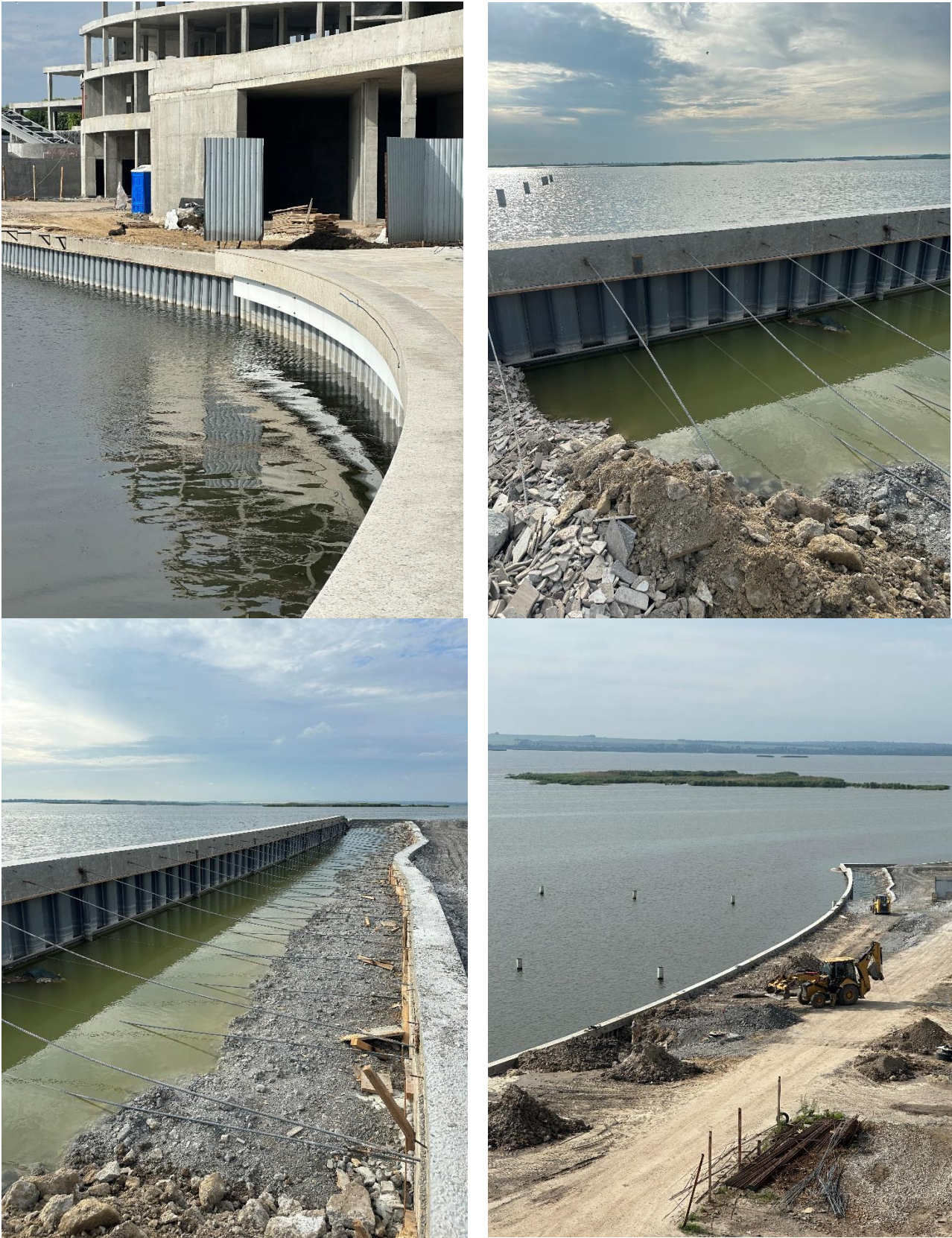
Рис.1 – Будівництво берегової лінії при будівництві готельного комплексу СанРей в м. Підгороднє в Дніпропетровській області
